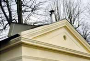
Poničené oplechování na budově márnice.
